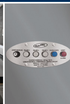
Station de commande dans la cabine
