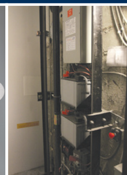
Mécanique 24V à l'intérieur de la cage d'ascenseur
