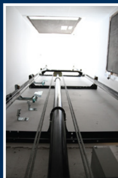
Rails d'ascenseur sur mur de bois avec finition Gypse
